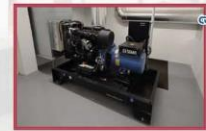
Das Dieselaggregat im Keller leistet 30 kVA und sorgt im Falle eines Stromausfalls für die Energieversorgung im Haus.
