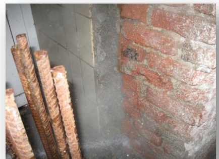
Brand Baustelle Bahnhof
